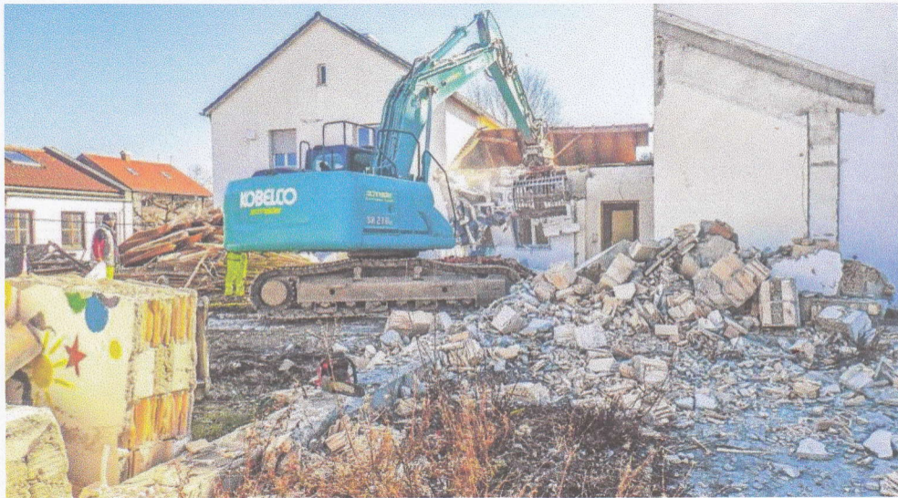
Nachdem das Gebäude entkernt worden war, haben gestern die Abrissarbeiten am evangelischen Gemeindezentrum begonnen.
